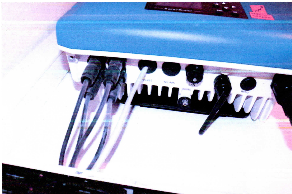
Bild 13: Fehlende Einbindung in den Potentialausgleich
