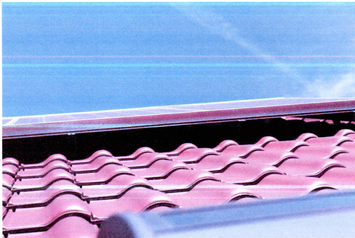
Bild 7: Zu geringer Abstand der Modulhalter zum Dach, Anschlussstecker liegen auf der Dachhaut
